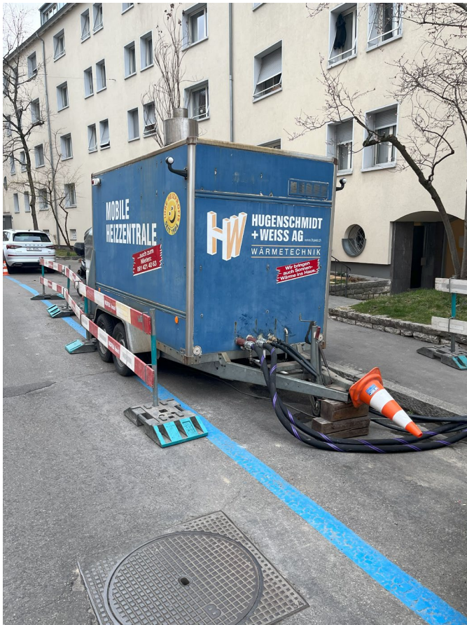
Mobile Heizzentrale Sierenzerstrasse 72
